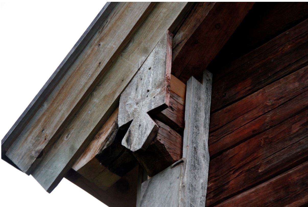
Figur 82. Hengebrett framfor lafteknute i gavlen mot fjorden. Foto Arlen Bidne/Vestland fylkeskommune, 2022.
