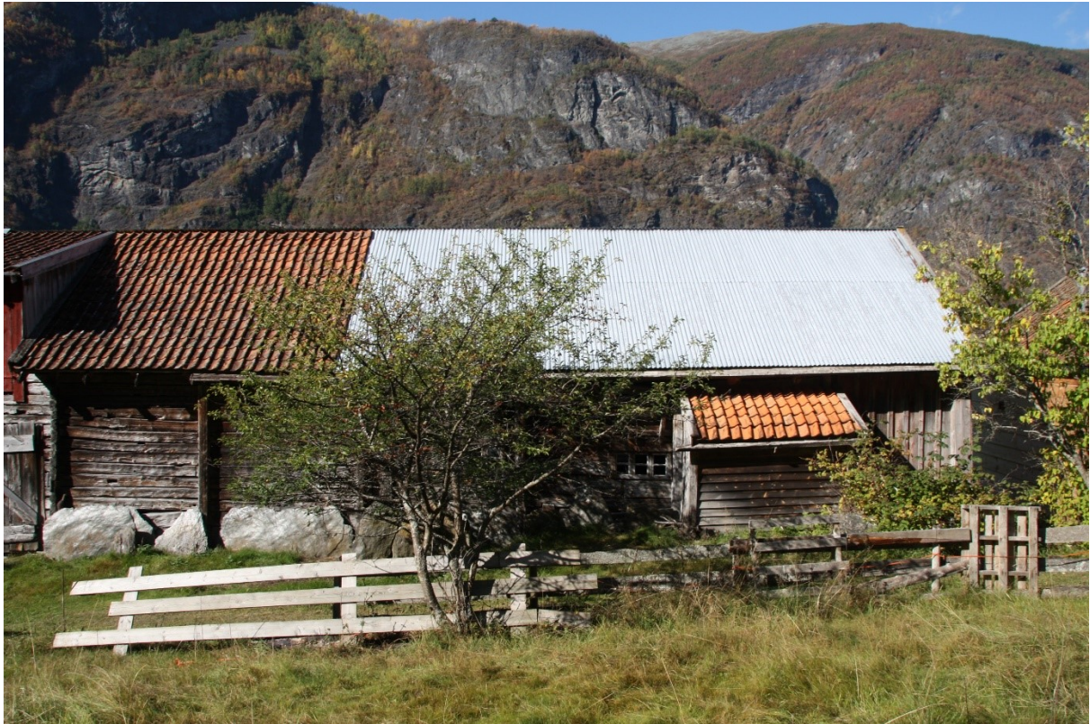
Figur 132. Langveggen sett frå hagen på oppsida av løa. Foto Arlen Bidne/Vestland fylkeskommune, 2021.
