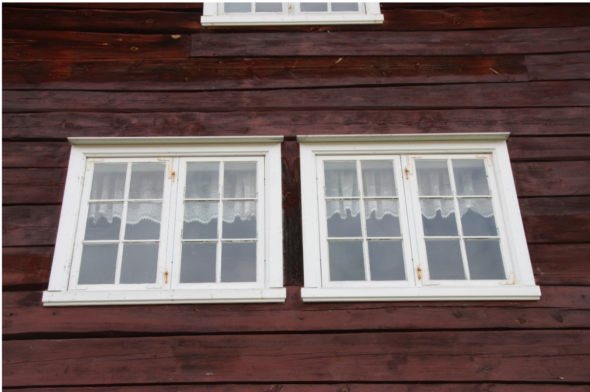
Figur 34. Vindauga i første etasje i gavlen mot fjorden. Foto Arlen Bidne/Vestland fylkeskommune, 2022.
