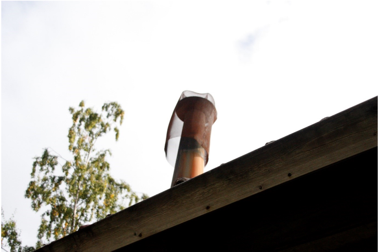
Figur 87. Nyare pipe som vart sett inn i samband med istandsetjinga. Foto Arlen Bidne/Vestland fylkeskommune, 2022.
