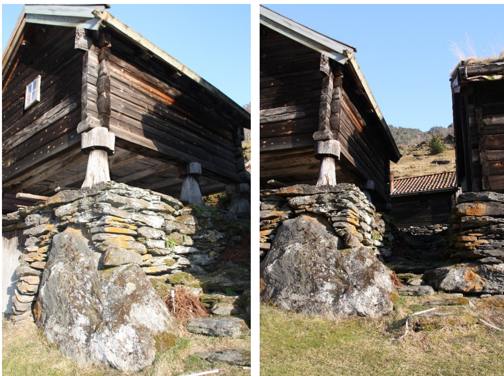
Figur 65 og figur 66. Langsida, med kjellarmur som er mura opp kring ein stor stein. Biletet til høgre viser trappa mellom stabburet og løa. Foto Arlen Bidne/Vestland fylkeskommune, 2022.
