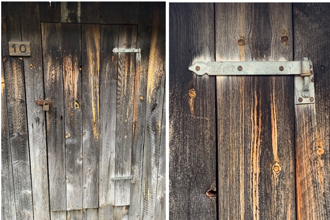
Figur 65 og Figur 66. Til venstre inngangsdøra til det yteste rommet i stabburet. Til høyre detalj av dørhengsla til same rommet. Foto Arlen Bidne/Vestland fylkeskommune, 2022.
