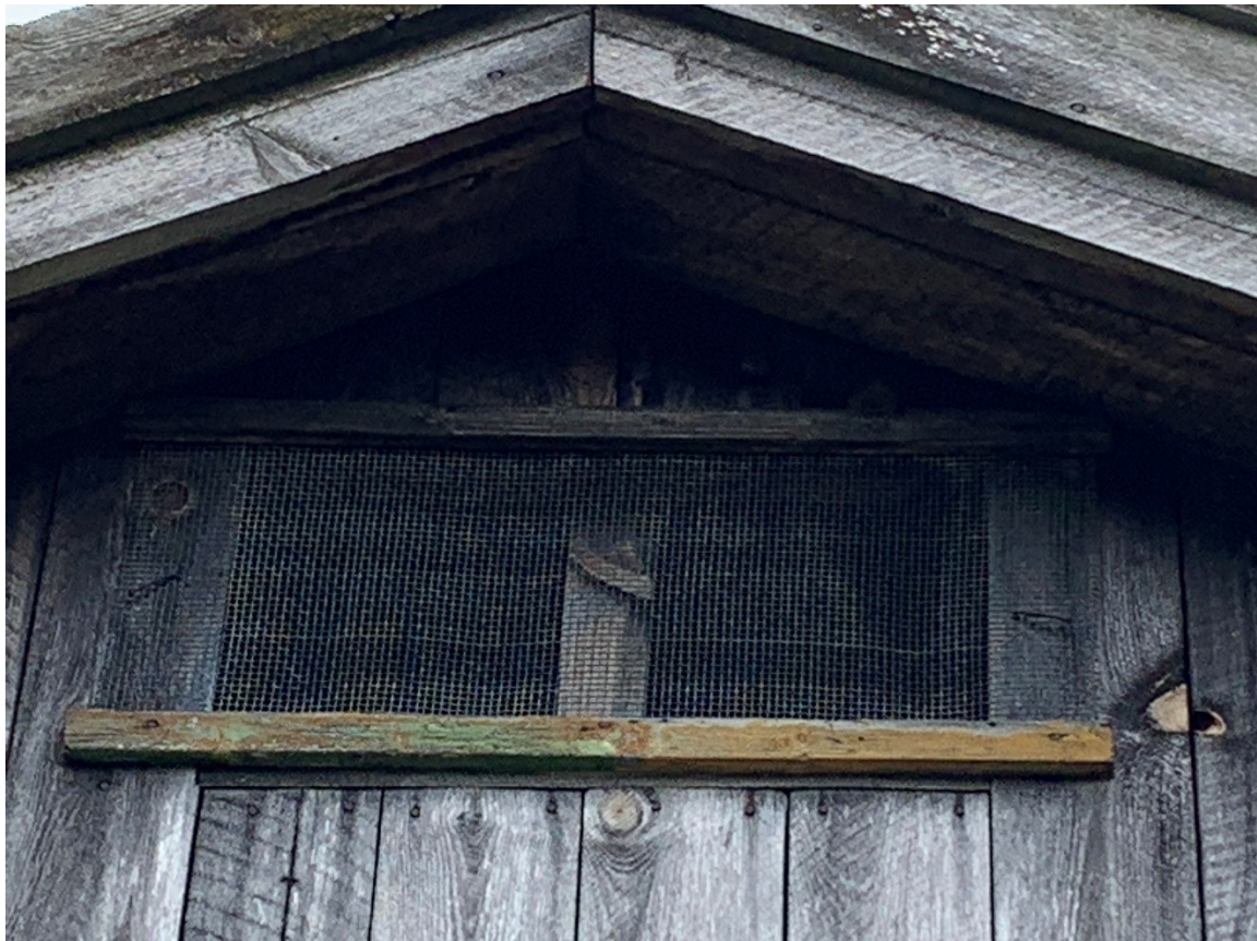
Figur 60. Lufteopning med netting øvst i gavlen mot fjordne. Foto Arlen Bidne/Vestland fylkeskommune, 2022.
