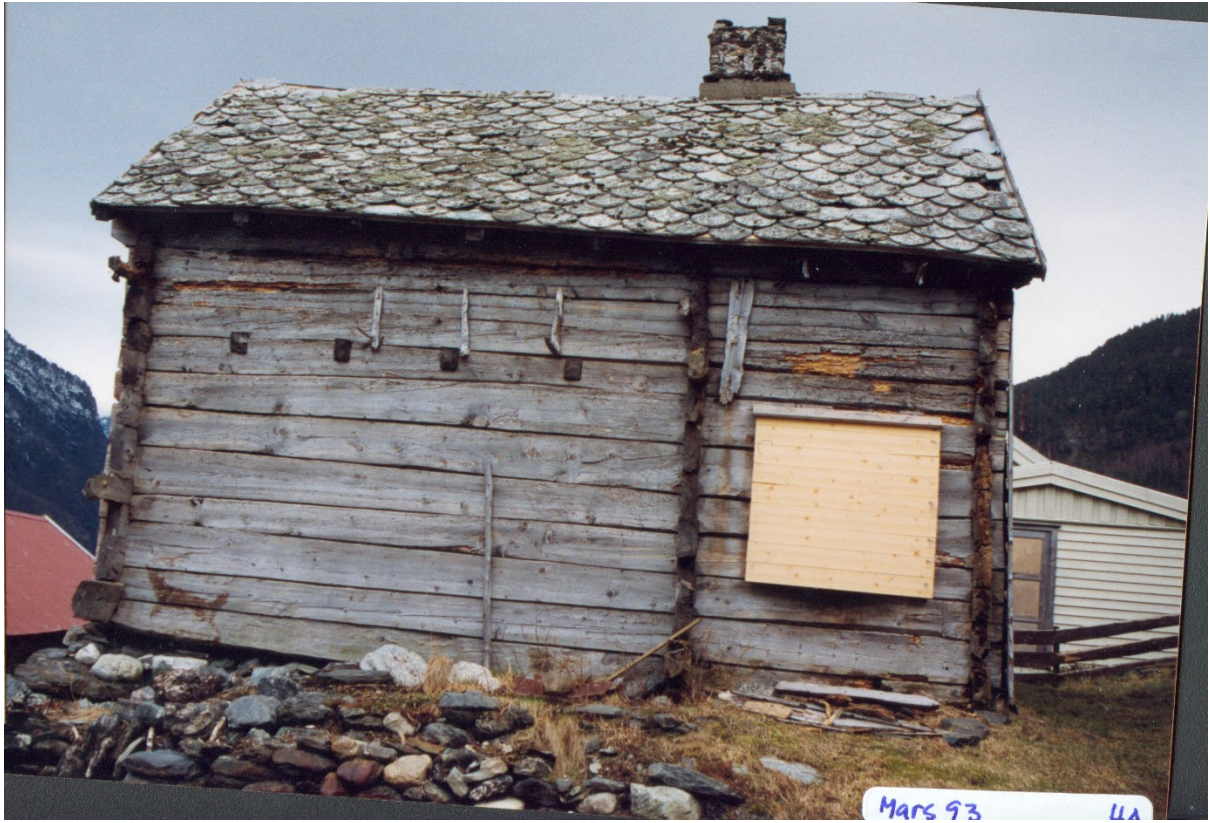
Figur 305. Linastova før istandsetjing. Foto frå Aurland kommune, 1993.
