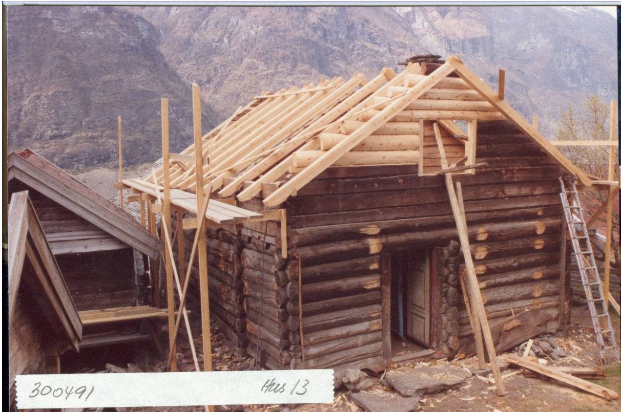
Figur 293. Gjertrudstova under istandsetjing. Utskifting av tømmer i gavlen og nye sperrer. Foto frå Aurland kommune.
