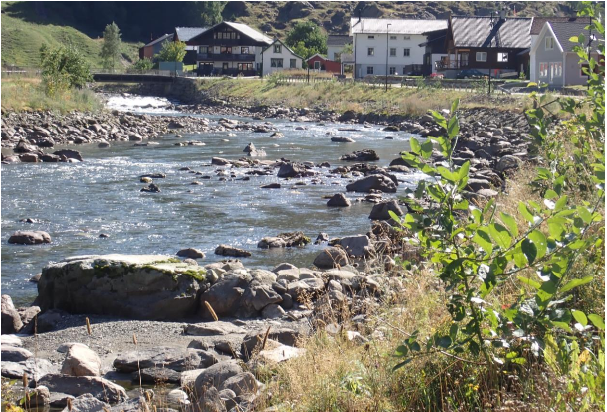
Figur 37 Miljøtilpasset steinsikring med steinutlegg foran sikringen og spirende kantvegetasjon i Flåmselva - en bedre miljøløsning enn glatt plastring dersom det trengs erosjonssikring.
