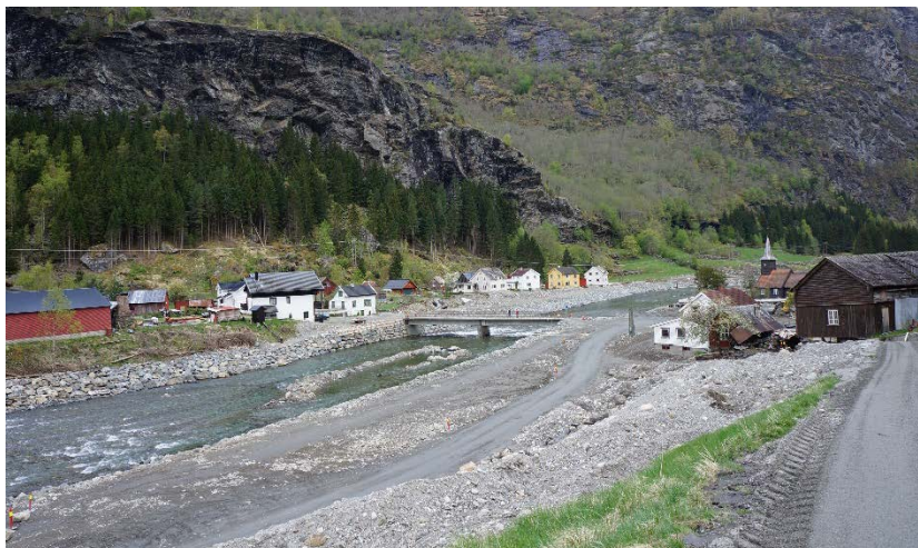
Bildet viser Flåmselva ved kirka hvor det ble store skader på bru, bygg og jorder. Sikringsarbeider med ny bru og erosjonssikring av elvebredd pågår og er delvis utført.
