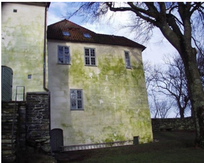
Økt vekst av grønske på fasader som stadig fuktes ned er et økende problem. Utstein kloster, Rennesøy kommune. Foto Johan Matsson / Mycoteam
