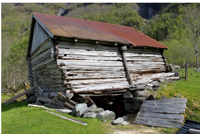
Tobakkshuset på Styvi i Aurland med omfattende råteskader. Foto: Gry Beate Mørk © Nærøfjorden Verdsarvpark
